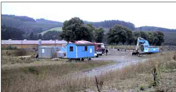
Im Holzgewerbepark Bad Fredeburg beginnt nach langen Jahren des Stillstands die erste Firma zu bauen.
